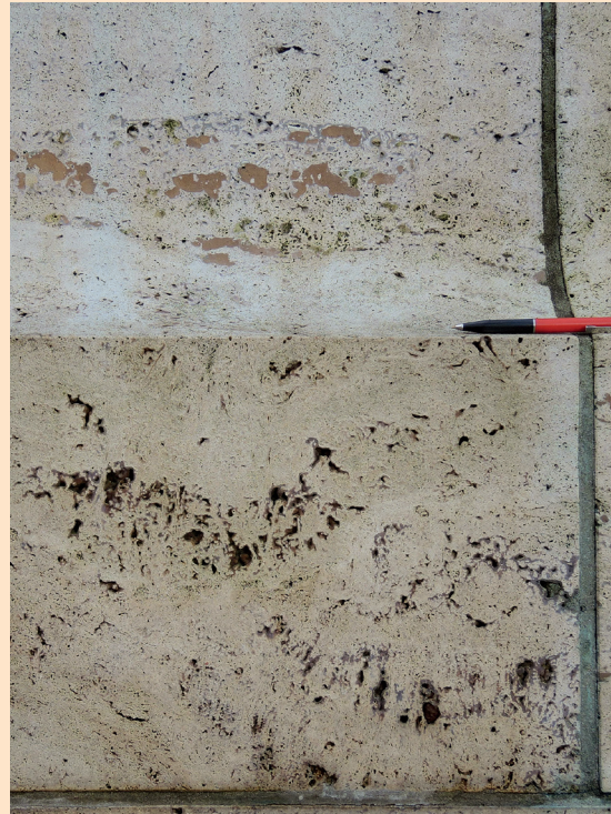
<<< Abb. P 2 Steuben-Denkmal , Schloßstraße; Sockel aus Langensalzaer Travertin; im oberen Teil mit verfüllten = gespachtelten Hohlräumen (hellbraun), im unteren mit offenen Hohlräumen (dunkelgrau) [Foto: Schroeder]
